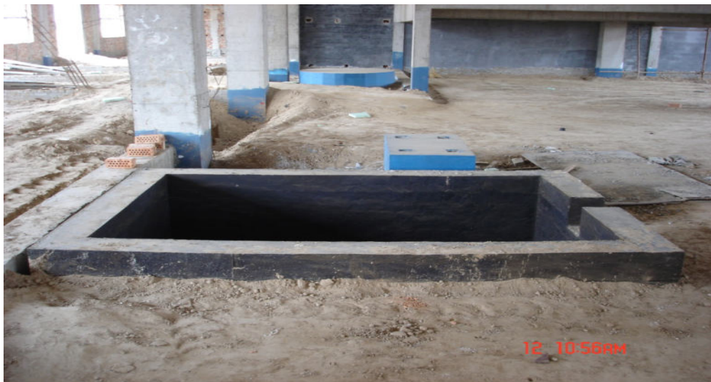
呖喃树脂混凝土集水坑
